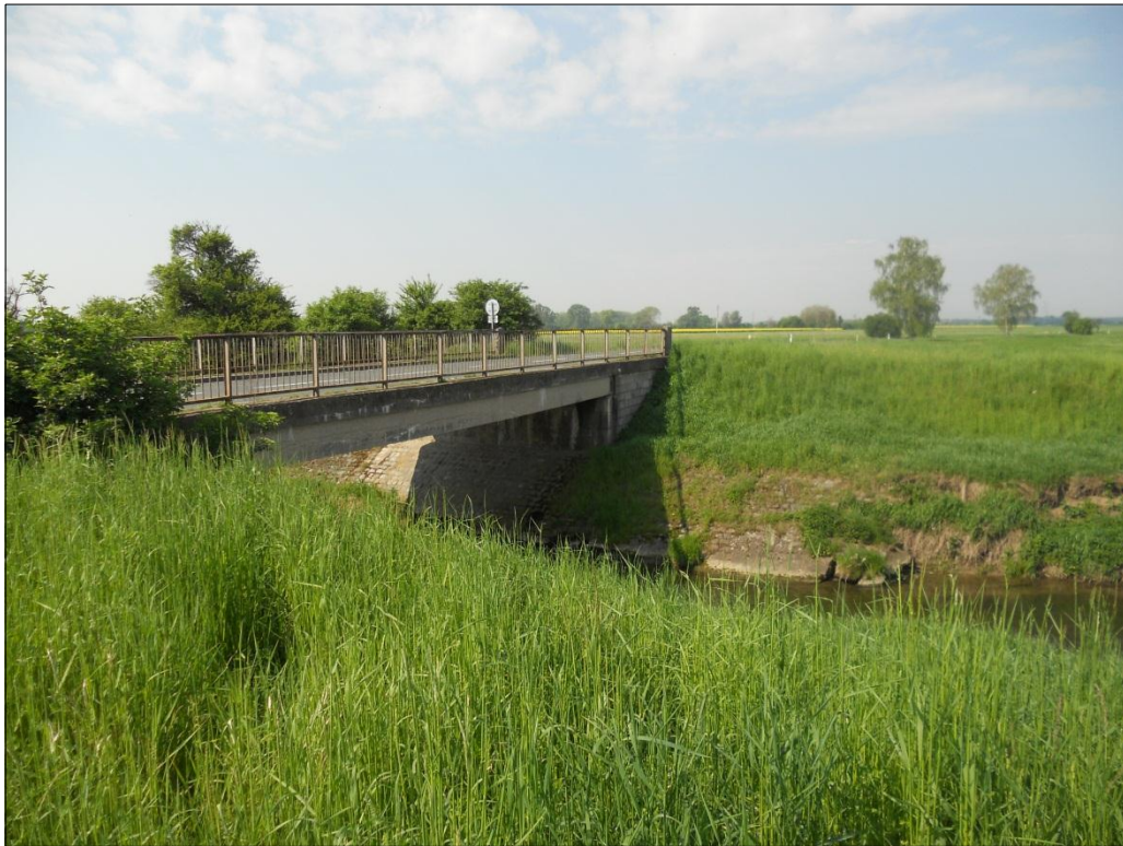
Obr. 29 Most v obci Říkovice, který by měl být v budoucnu opraven (foto: R. Možišová, duben 2014)
